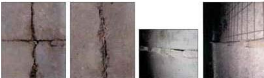
Aspecto de una losa que ha sufrido retracci n
